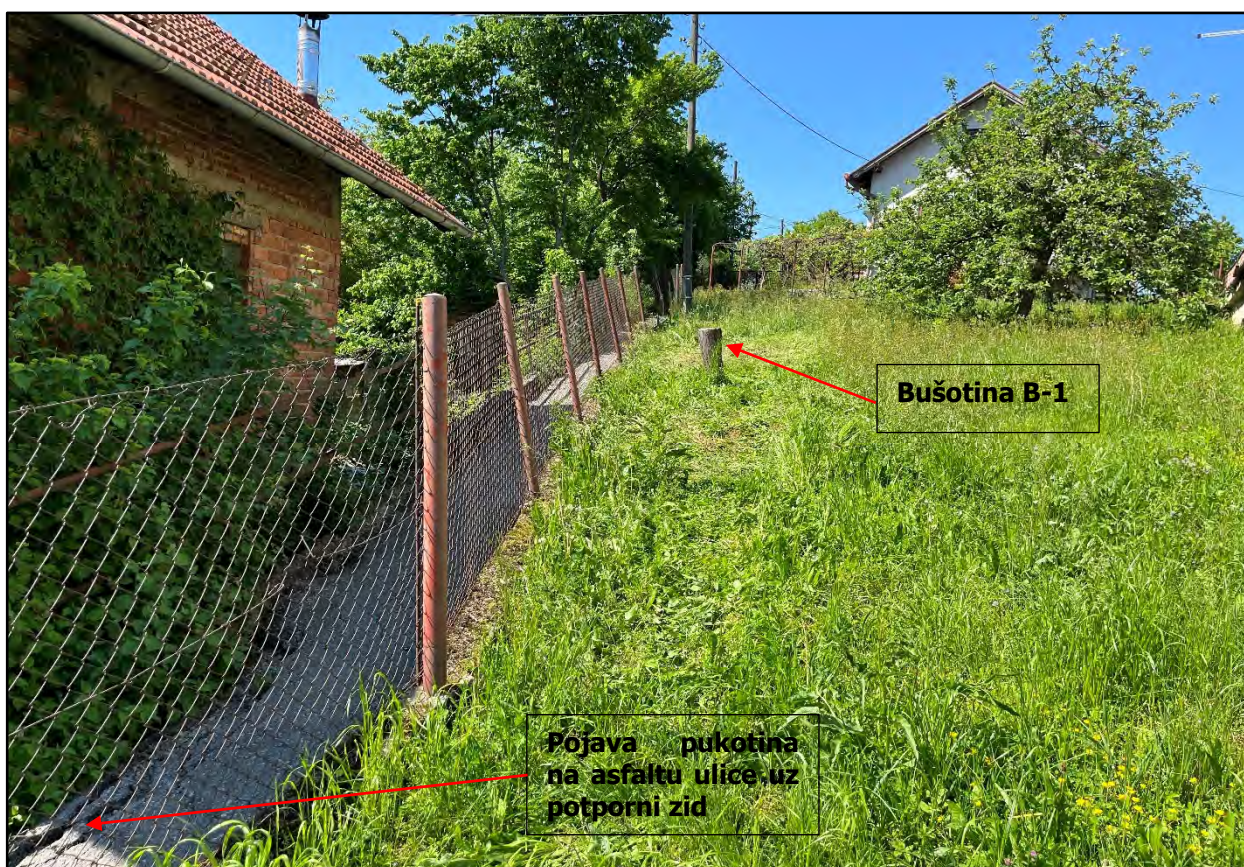
Slika 4. Prikaz klizišta u Gunduličevoj ulici i pozicije geotehničke istražne bušotine B-1
